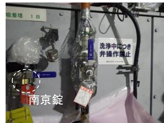
弁のロック状況写真（一例）
