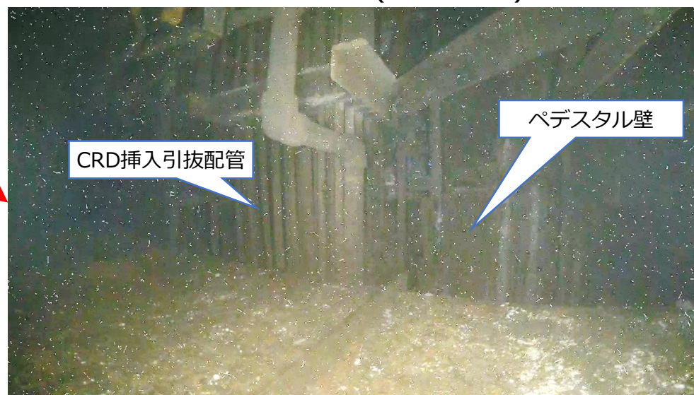
写真2.CRD挿入引抜配管の状況
