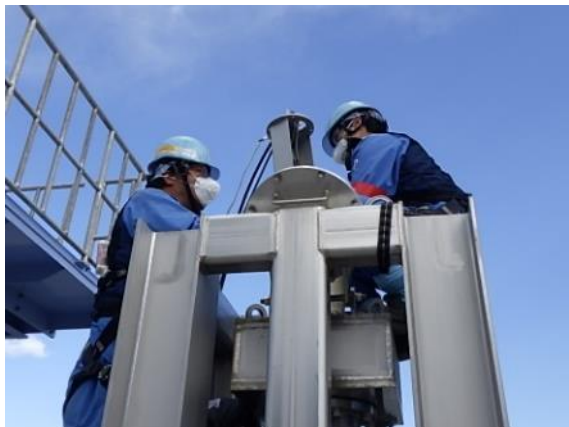
ガイドパイプ上部からの検出器等の引き抜き
