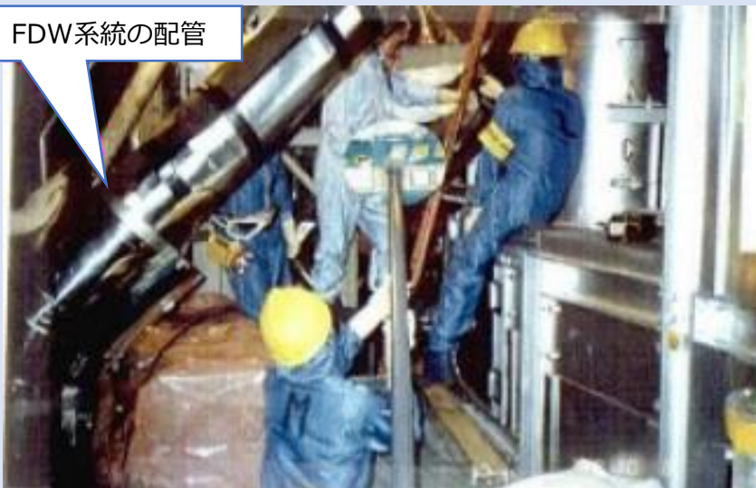
【震災前：定期検査時】FDWシステム配管
