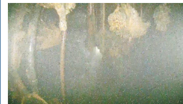
⑦：落下した構造物 A
