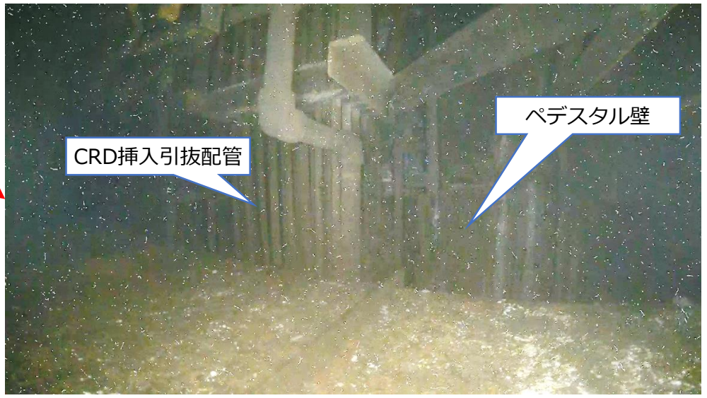
写真2.CRD挿入引抜配管の状況
