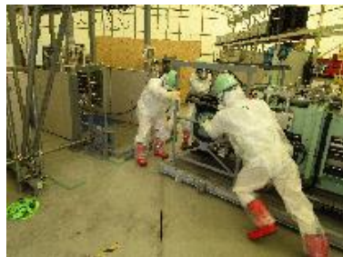
堆積物除去装置 (低圧水) 設置
