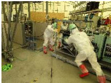
堆積物除去装置 (低圧水) 設置
