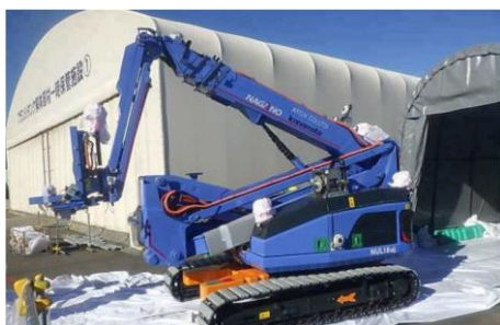
○高所作業台車 \gamma イメージャ/FirstLook/SPOTを 搭載するための架台を設置し、 各階に運搬
