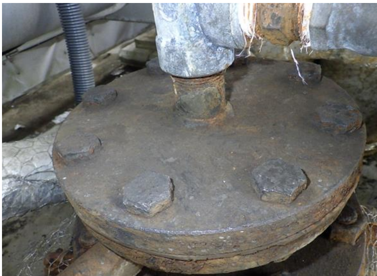
清掃前の凍結管
