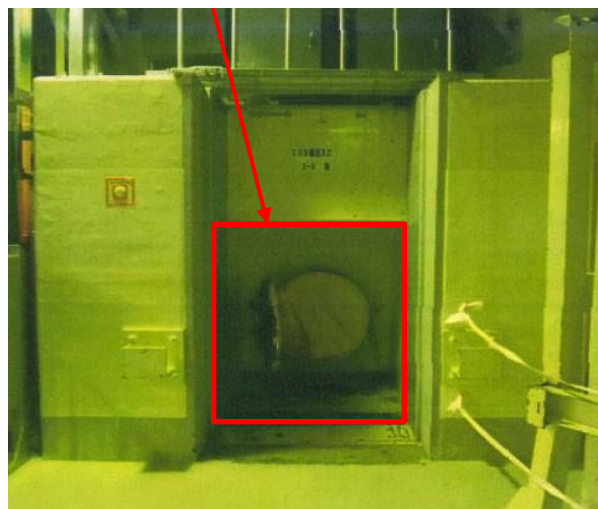
X-6ペネトレーション前 (震災前の定期点検時:遮へいなし)
