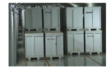
固体廃棄物貯蔵庫
