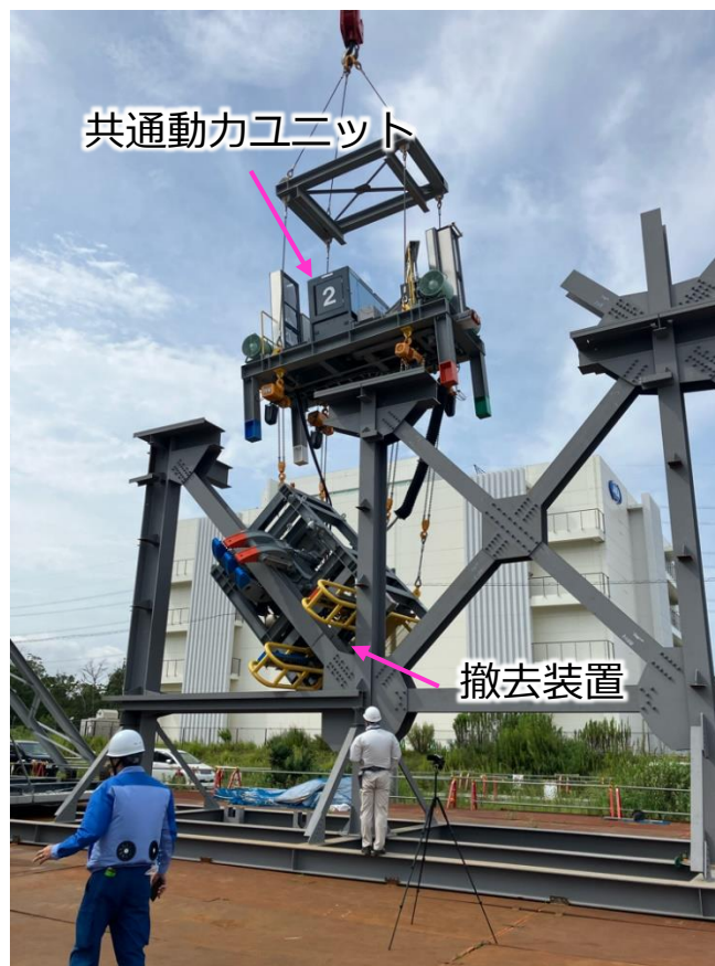
ブレース切断状況 (撮影:8月22日)
