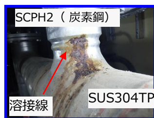
＜⑫の外表面腐食・補修状況＞
