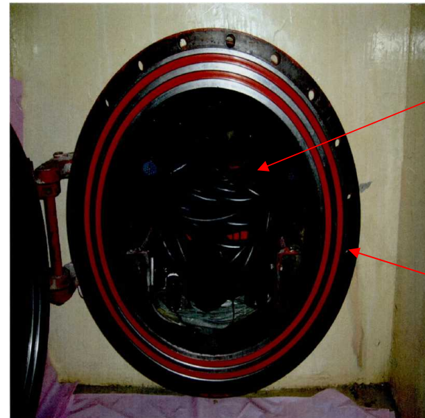
保管されている ケーブル類
