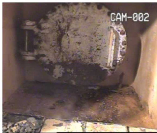
X-6ペネトレーション前 (コンクリートブロック撤去後)
