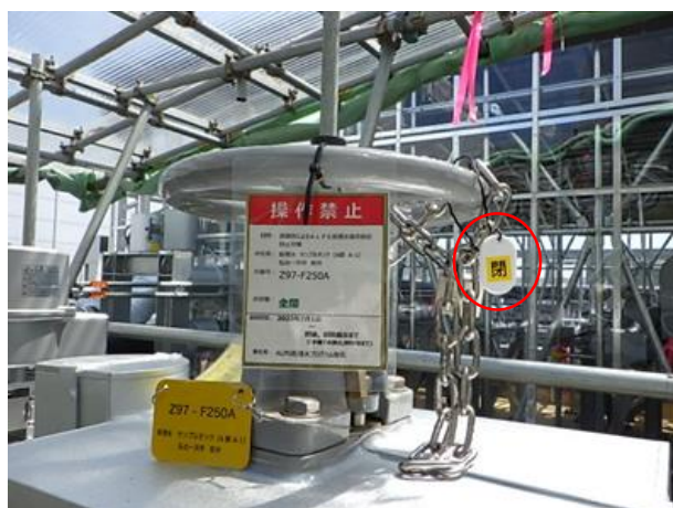
作業中における弁の開閉状態表示
