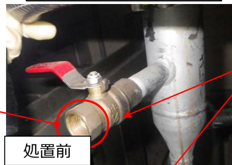
ベント弁の現場状況
