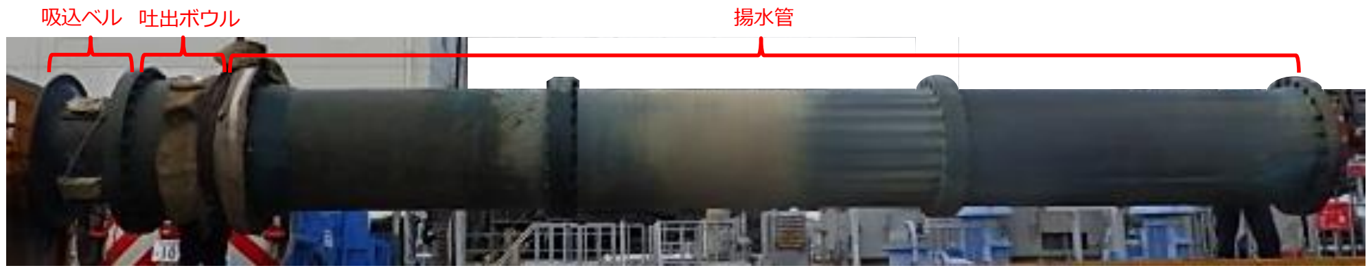
海水移送ポンプC系 (分解前)
