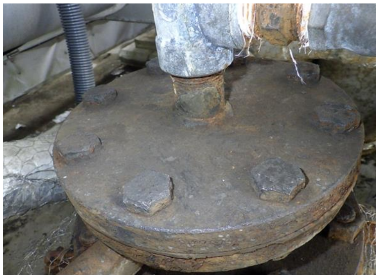
清掃前の凍結管
