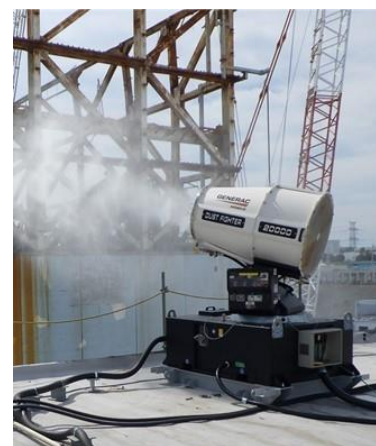
噴霧装置による散水状況
