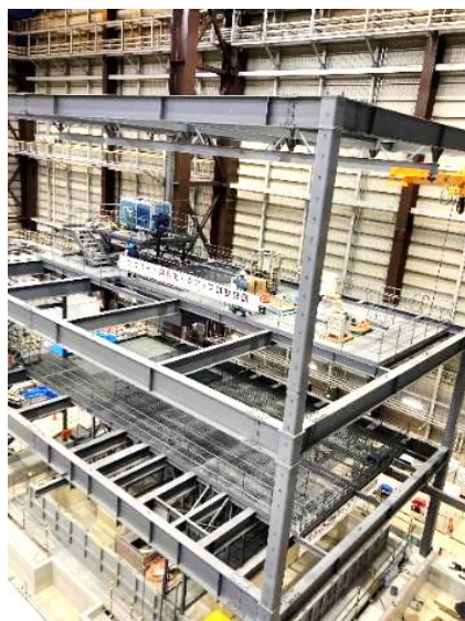
モックアップ設備
