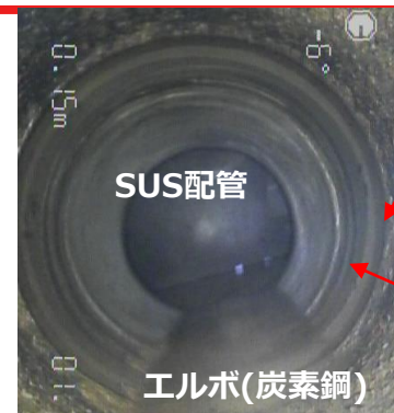
3 SUS側と炭素鋼の異材溶接部
