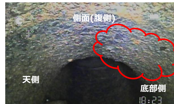
5 減肉傾向箇所Ⅱ,Ⅲ(温度検出器下流側の側面)
