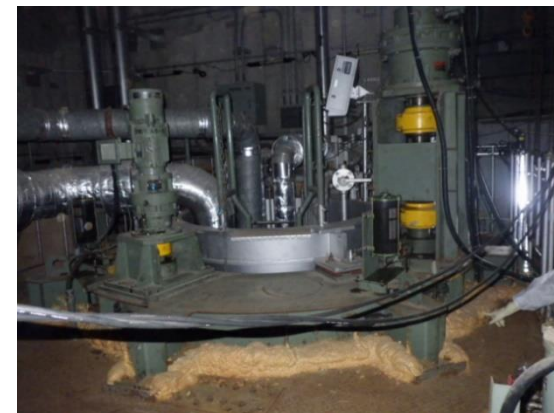
③高温焼却炉の状況※
