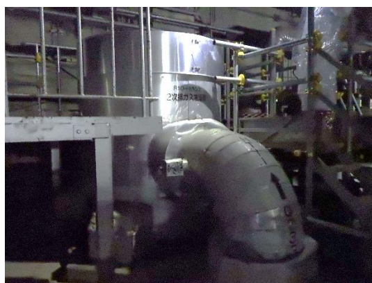
②排ガス冷却器の状況※
