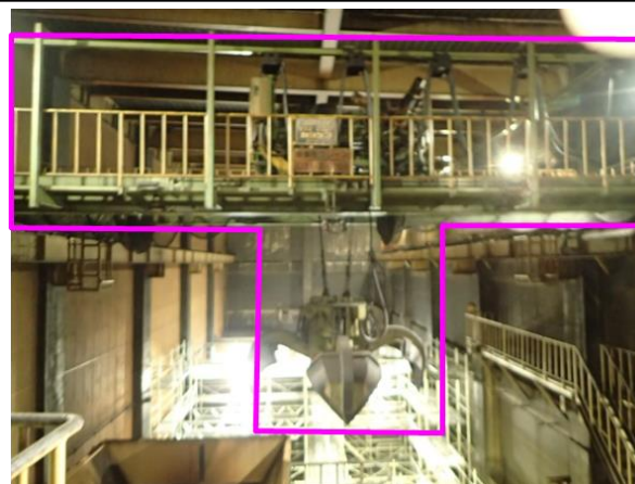
廃棄物クレーン
