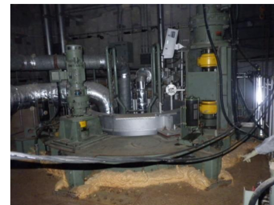
③高温焼却炉の状況
