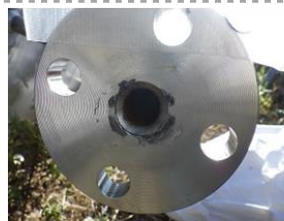
計装配管 フランジ部
