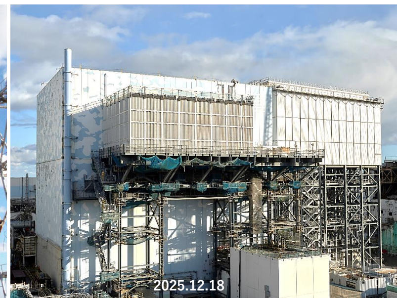
2号機 原子炉建屋の状況
