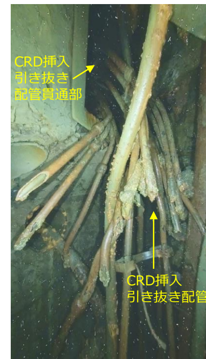
③：CRD挿入引き抜き配管(南東)
