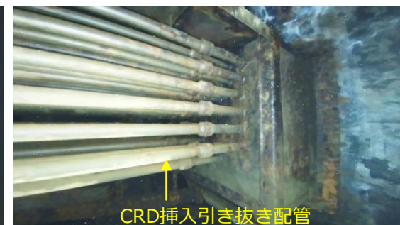
③：CRD挿入引き抜き配管(北西)
