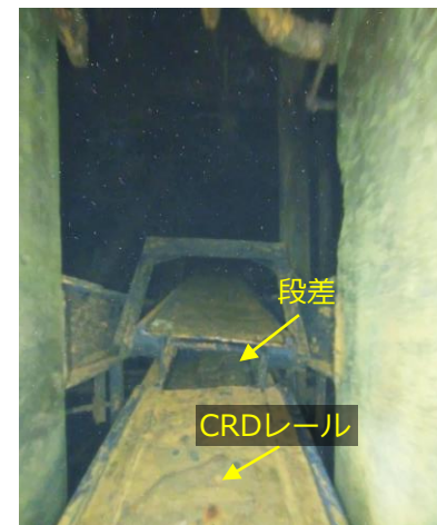
④ : CRDレールの段差箇所
