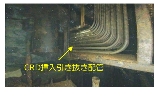
③：CRD挿入引き抜き配管(南西)
