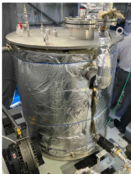
凝縮水タンク
