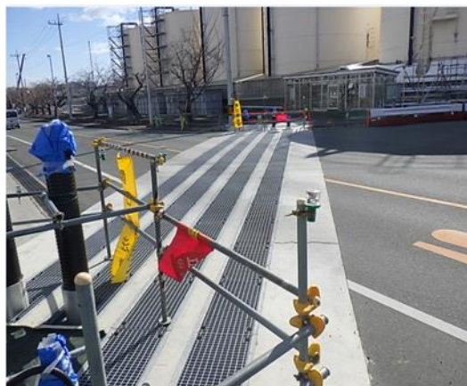
【移送配管（横断部）】撮影方向① (2026.2.3)
