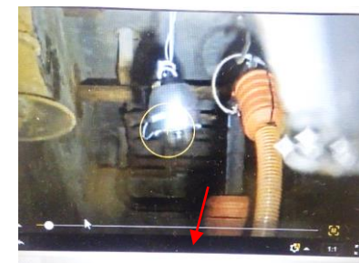
ホースが下方向へ沈んだ状態
