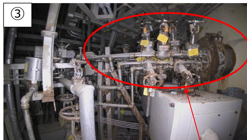
再循環ポンプ計装ライン
