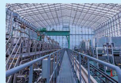
多核種除去設備 (ALPS)
