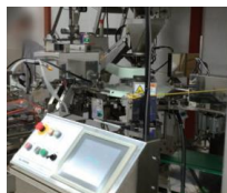
導入した設備
