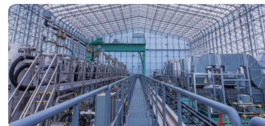
多核種除去設備 (ALPS)
