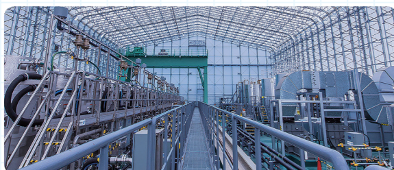
多核種除去設備 (ALPS)
