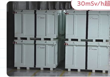
固体廃棄物貯蔵庫
