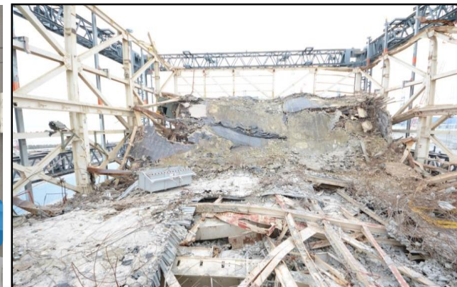
崩落屋根状況
