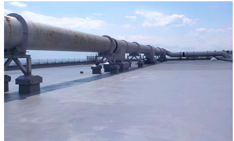
【現況】4号機T/B屋根（防水工事中） : 0.2mSv/h
