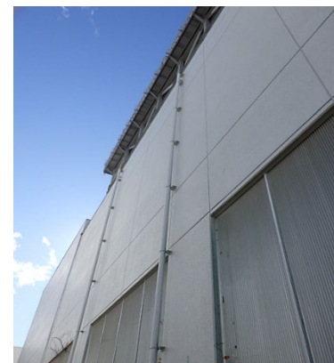
雨水排水設備
