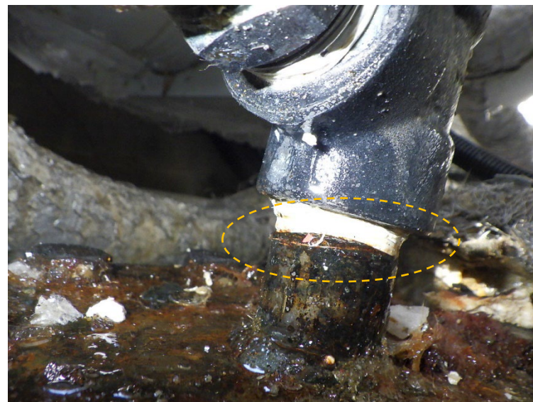
凍結管継手部 漏えい箇所
