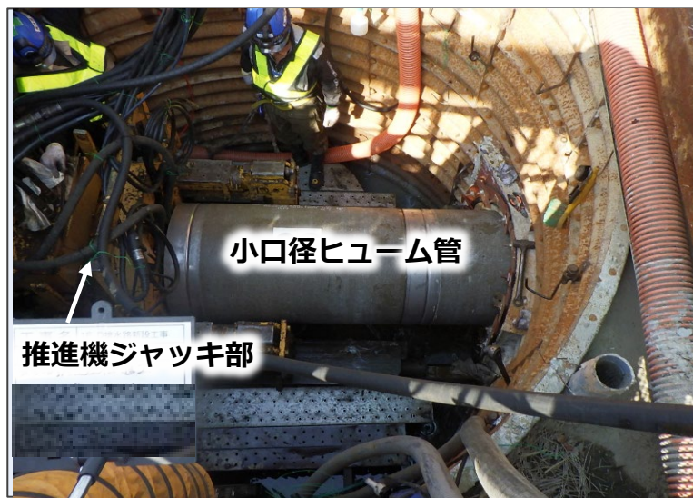
写真④ 小口径_接続桝B
