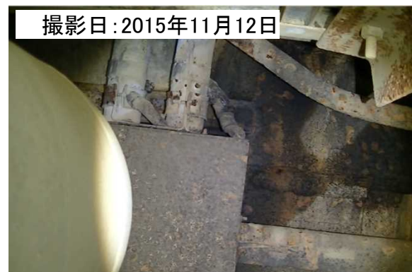
流入箇所下部の写真
