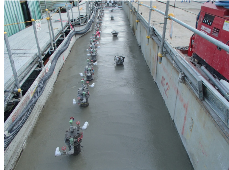
写真⑬-2 13BLK配管架台
