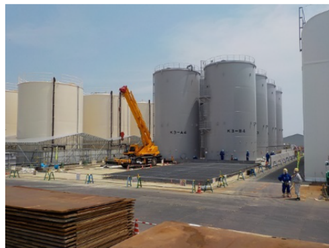
700m 3 級溶接タンク
