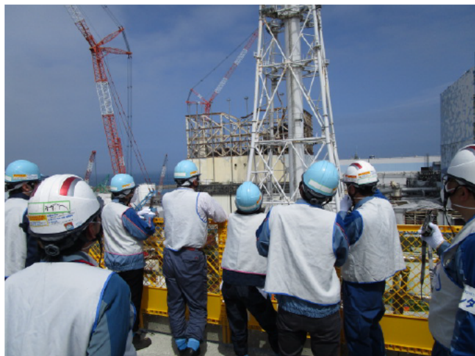
1～4号機俯瞰(1号機)
