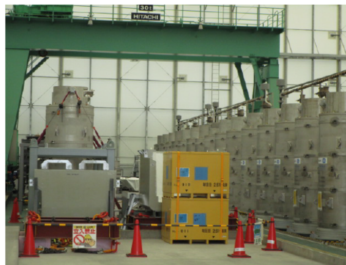
多核種除去設備(内部)
