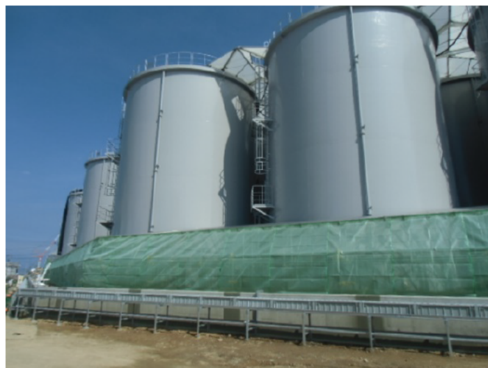
タンク堰カバー
