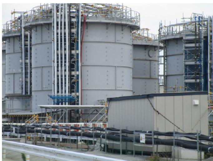
フランジ型タンク
