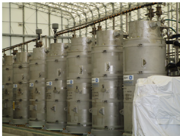
多核種除去設備(吸着塔)
