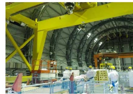
クレーンと燃料取扱機
