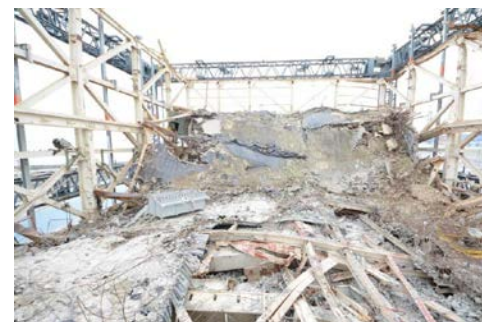
建屋上部のガレキの状況
