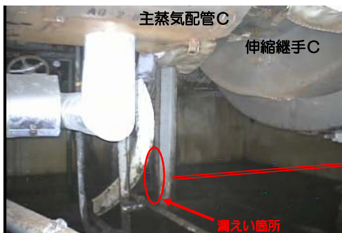
主蒸気配管D（主蒸気配管Cの奥側）
