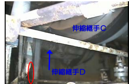
主蒸気配管D
