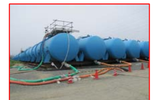
鋼製横置きタンク (蒸発濃縮水タンク)
