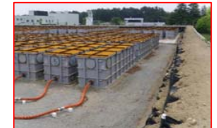
鋼製角形タンク (淡水、RO廃液)
