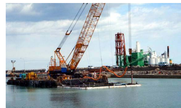
図3：1～4号機取水路前面エリアでの海底土被覆本格施工の様子
