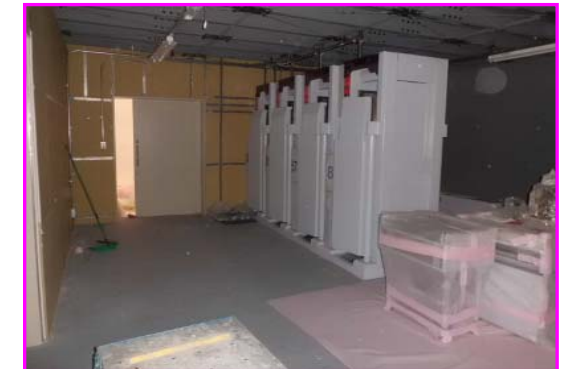
⑥ゲートモニタ設置
