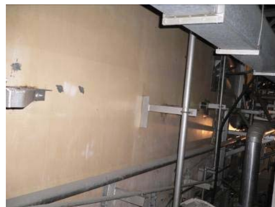
使用済燃料プールを支持する壁
