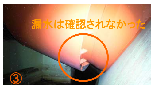
ベント管ベローズカバー下部
