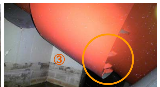
ベント管ベローズカバー下部
