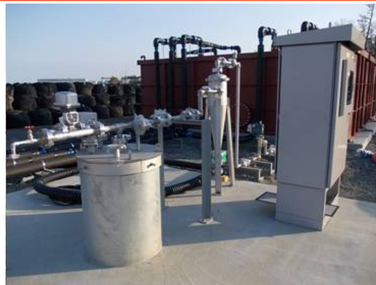
No. 9揚水井および揚水・移送設備
