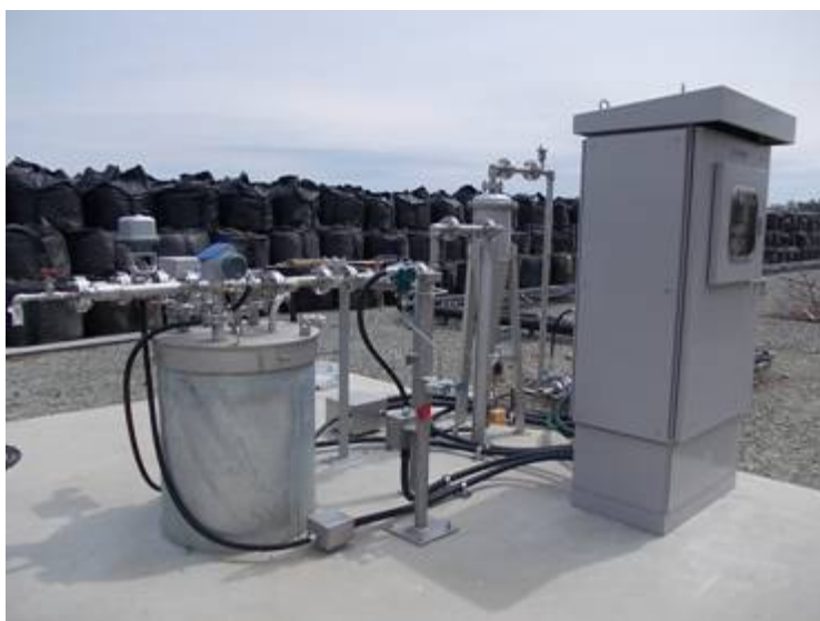
No.11揚水井および揚水・移送設備
