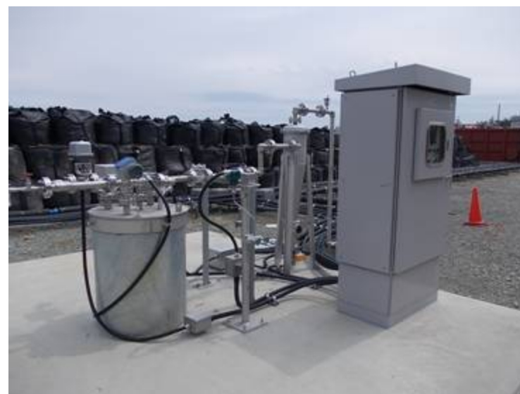
No. 12揚水井および揚水・移送設備
