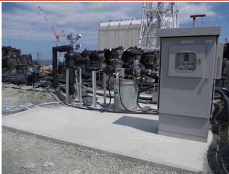
No. 3揚水井および揚水・移送設備
