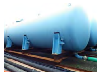
鋼製横置きタンク
