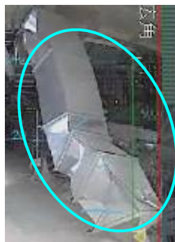
撤去対象物例： 落下したダクト
