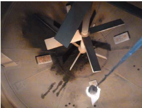
①バッチ処理タンク2C
