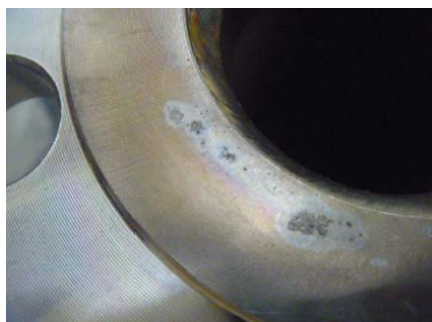
スラリー移送ポンプ出口配管（拡大） フランジシール面に すき間食有り
