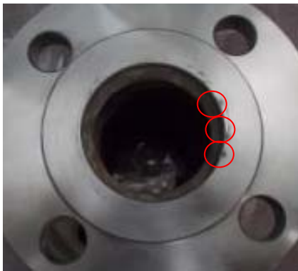
⑦供給ポンプ1出口配管フランジ
