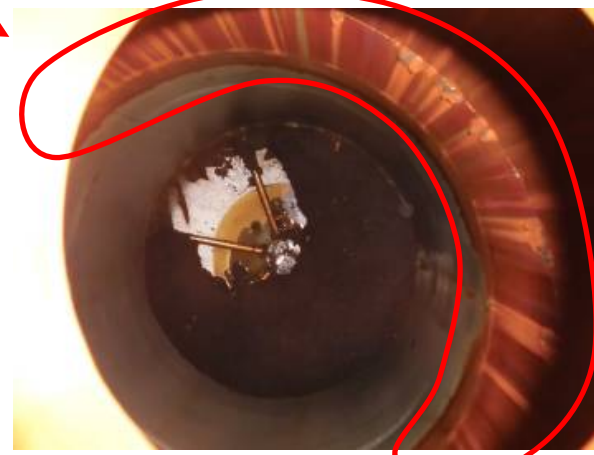
吸着塔内溶接線 近傍の腐食痕*
