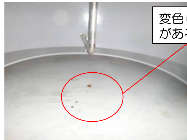
②漏えい水受けパン状況
